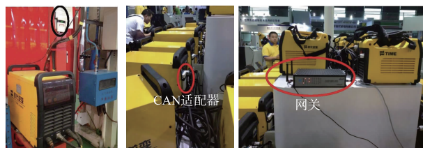
图6 焊机系统应用
