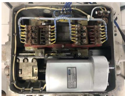
(a) ZDJ9 转辙机内部结构
