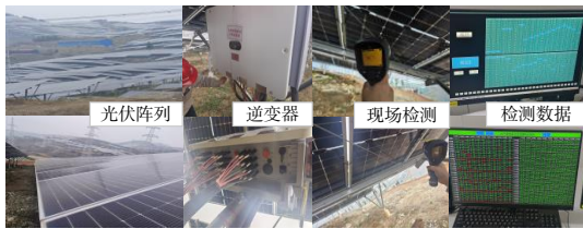
图 14 大唐华银涟源新能源湖泉光伏电站现场及装置
